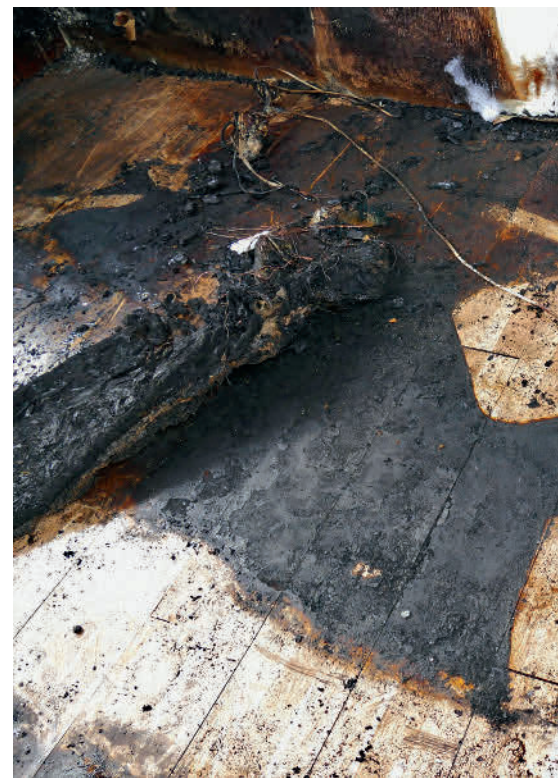
Ein Teil des Bodens des Schlafzimmers während der Brandschuttverlagerung.
