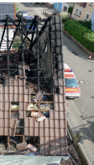
Fotos brandbeschädigter Häuser von oben können wichtige Erkenntnisse bringen.
