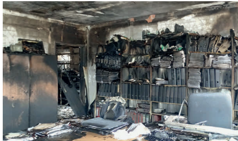
Ausgebrannte Büroräume hinter dem Verkaufsraum.
