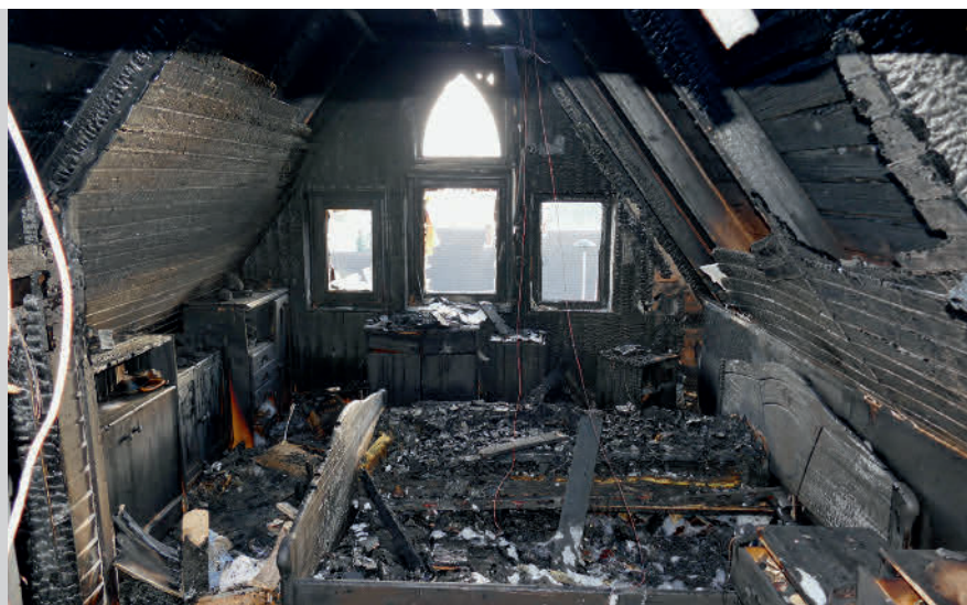
Ein ausgebranntes Schlafzimmer im Dachgeschoss.
