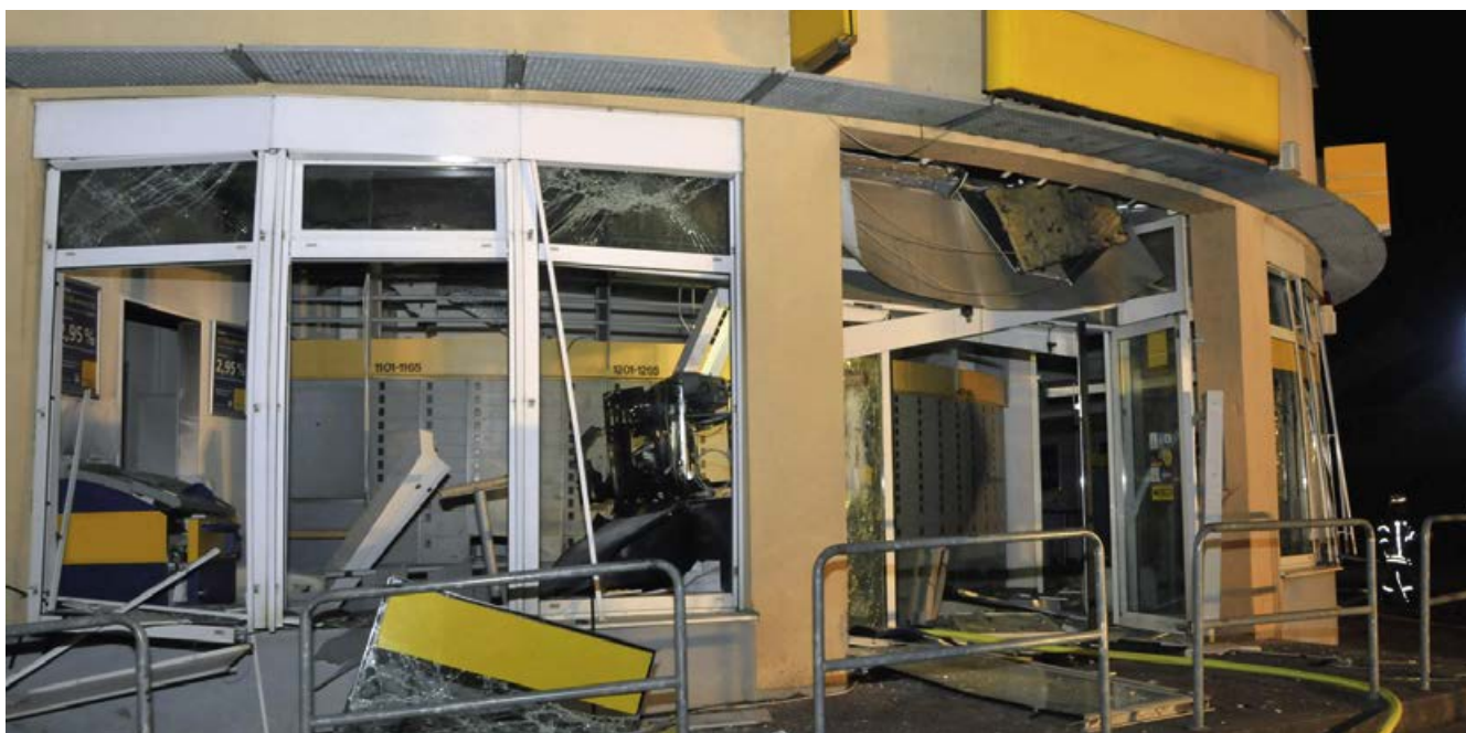
Durch die Explosion völlig zerstörter Eingangsbereich der Bankfiliale. Gut zu erkennen: Der ausgebrannte und verkohlte Geldautomat.
