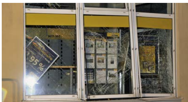
Die Explosion zerstörte Fenster und Türen und sorgte für einen Folgebrand.
