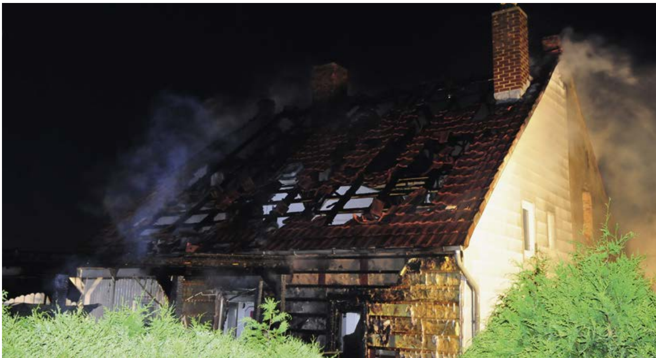
Das Wohnhaus von der Rückseite. Hier hatte sich der Brand auf das Dachgeschoss ausgebreitet.
