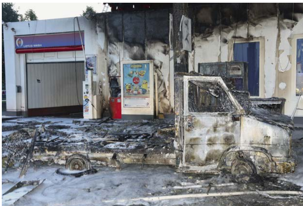
Das ausgebrannte Wohnmobil. Der Brand zerstörte nicht nur die Zapfsäule, sondern auch Teile des Tankstellengebäudes.
